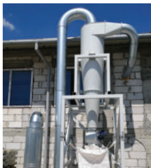
Odpylanie centra obróbczego CNC płyt OSB
