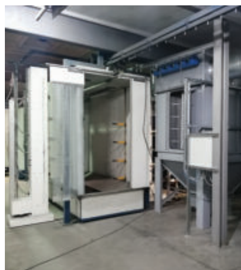
Odpylanie automatycznej linii malowania proszkowego
